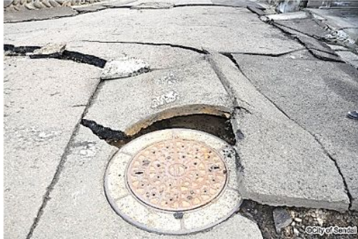
△震災による被災状況(仙台市HPより)
