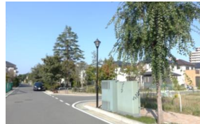
↑写真-2 歩道内の地上機器
