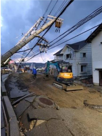
石川県輪島市 国道249号
