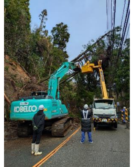
石川県穴水町 県道303号
