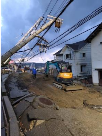
石川県輪島市 国道249号
