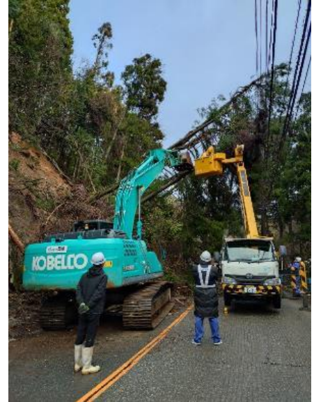
石川県穴水町 県道303号
