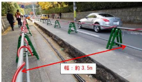
実証実験による設置例(東一条通)
