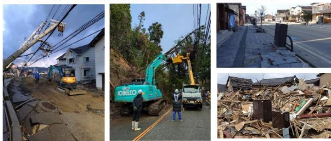
石川県輪島市 国道249号※ 石川県穴水町 県道303号※ (上) 輪島市県道1号(下) 穴水町県道1号
