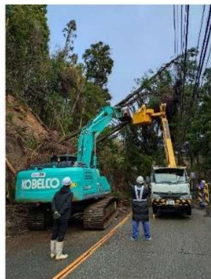
石川県穴水町 県道303号
